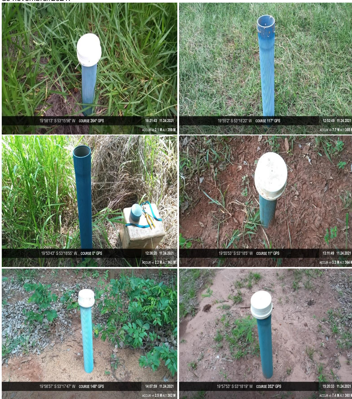
Figura 2 - Poços de monitoramento da PCH Verde 4. Pontos de cima para baixo: P1 a P6. Campanha de novembro//2021.
